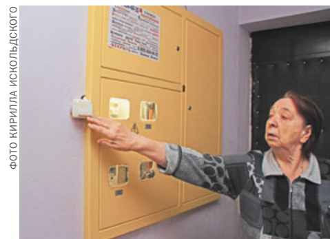
Со светильником внутри электрощитка снимать показания счётчика намного удобнее.
