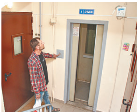
Двери подъёмника работают исправно.
